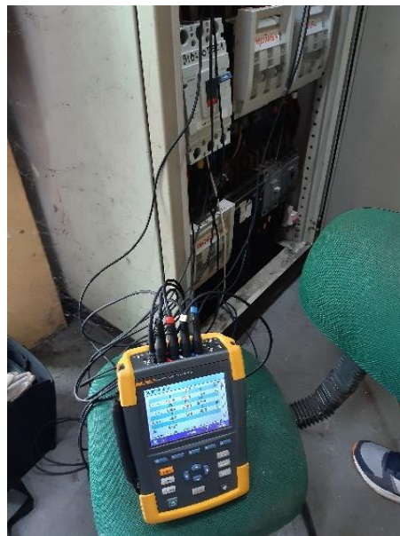
Figura 2: Analisador de energia conectado ao quadro geral
